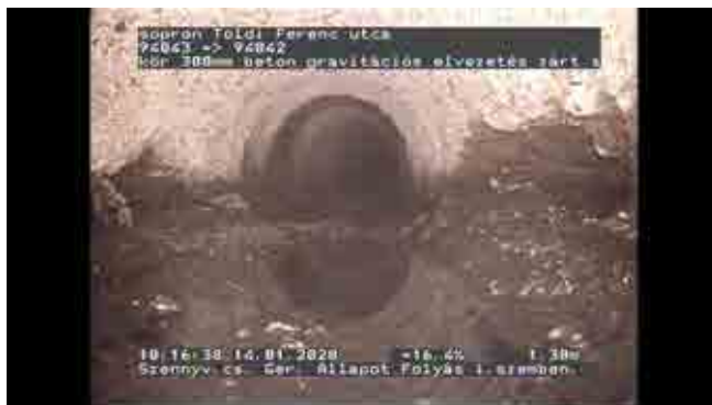
Soproni szennyvízcsatorna hálózat, beton korrózió (Toldi – Vághy u),
