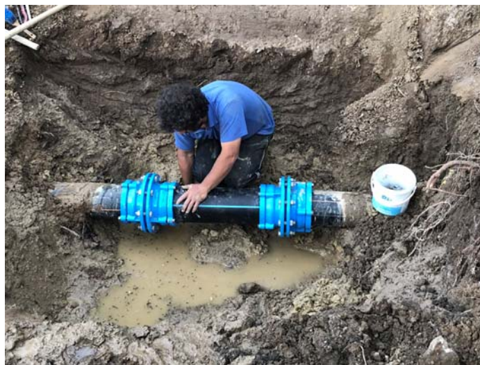
M85 útépítés szennyvíz nyomóvezeték szakítás
