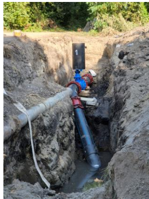
Fertőd , Keleme-patak szennyvíz nyomócső csőhíd kiváltás
