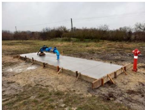
Sopronkőhidai U3 kút rendszerre kötése
